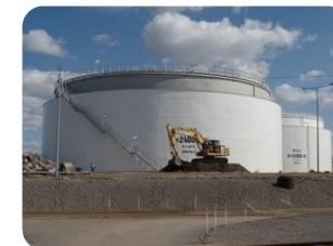
Radzionków 2 storage tanks à 24,000 m 3
